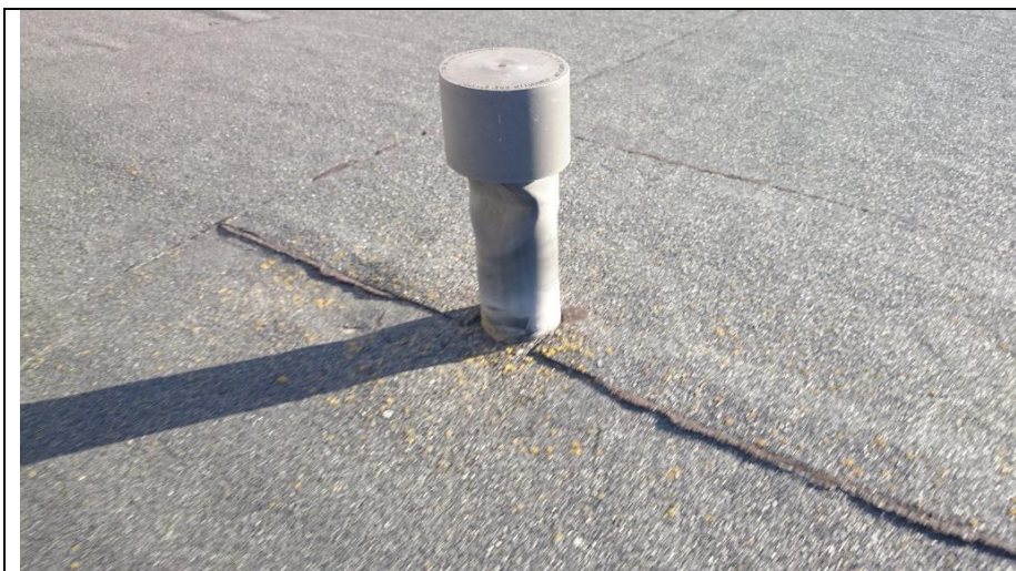
Pilt 14. Katuse torustike läbiviigud ei vasta nõuetele, millest võivad tekkida läbijooksud.
