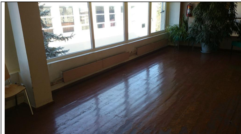
Pilt 31. Vanemas hooneosas on vanad radiaatorid.
