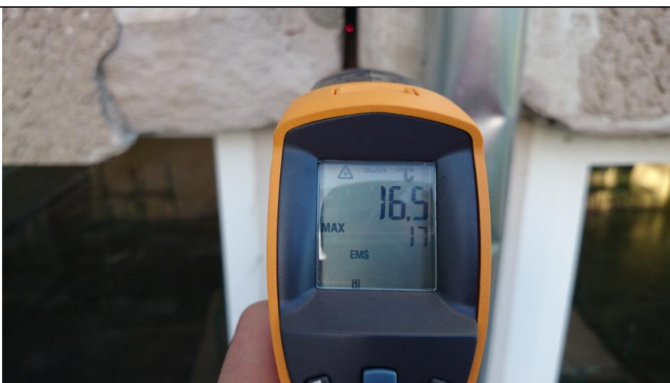
Pilt 8.3. Hoone vuugis on temperatuur 16,5 kraadi ehk mõõtmisega on näha soojuse leket.
