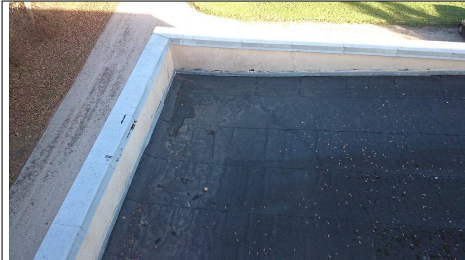
Pilt 15. Katuse SBS katte ülespöörded ei vasta nõuetele. Liiga vähene ülestõste kahjustab seinakonstruktsiooni.
