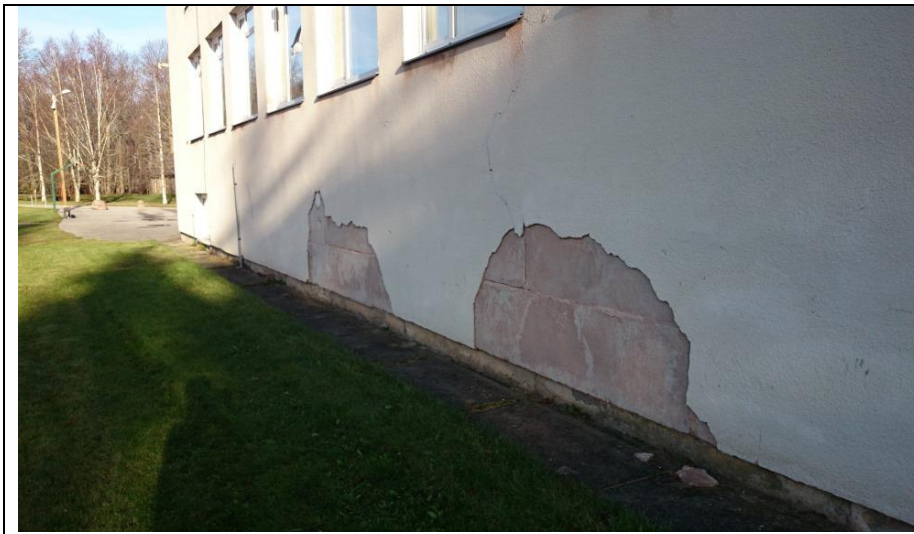
Pilt 5. Betoonist veetõkkeriba on vale kaldega. Ebapiisava horisontaalse hüdroisolatsiooni puudumiseta on seina alumine pind kahjustatud.
