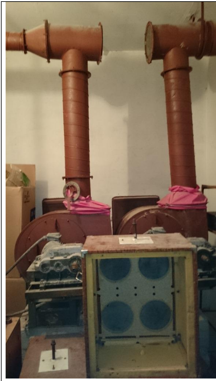
Pilt 21. Olemasolev ventilatsioonisüsteem on amortiseerunud ja ei kasuata.
