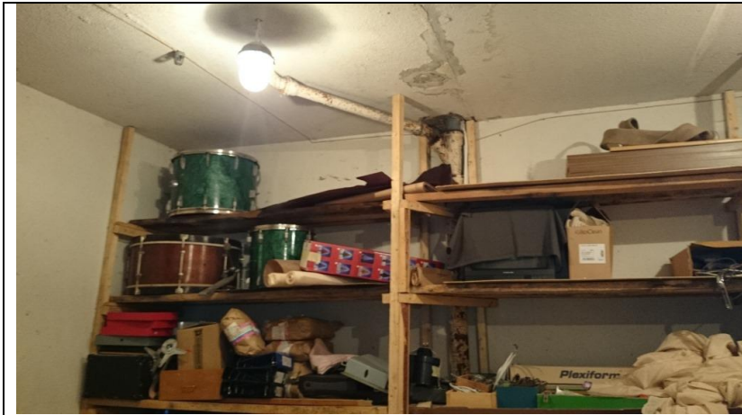
Pilt 20. Vana kanalisatsioonitoru, laes- seinal veekahjustused.
