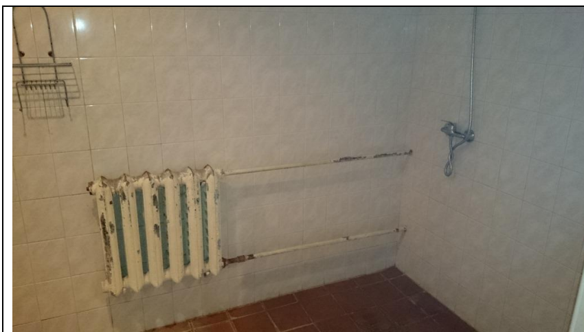
Pilt 26. Radiaator ja torustik roostekahjustustega (vale viimistluse valik märjas ruumis).
