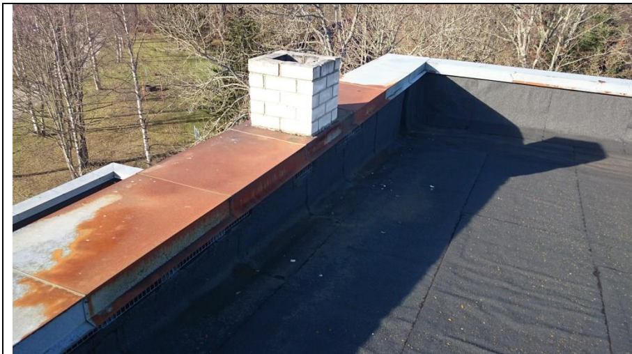
Pilt 16. Katuse parapeti plekk on valesti paigaldatud (pleki ebapiisav ülestõste korstna juures ja pleki kinnitusklambrid on katki).
