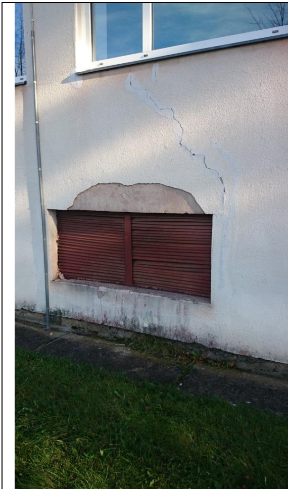
Pilt 6. Ventilatsiooni õhuvõtu ava peal on silluse kandepikkus vale. Õhuvõtu all puudub veeplekk ja tulevalt sellest on alumine osa lagunenuud.
