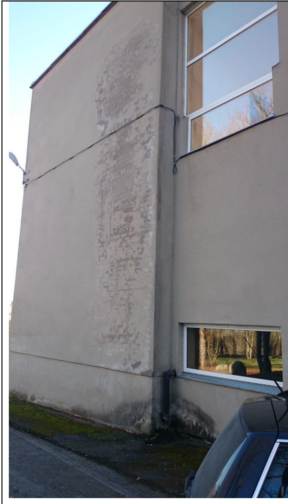
Pilt 3. Katuse äravoolu trapi ummistuse veekahjud seina konstruktsioonis.
