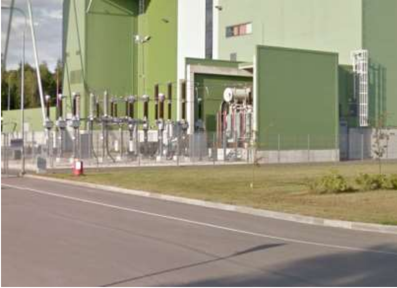
Foto 2. Illustratiivne näide alajaamast.
